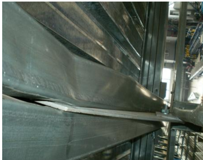
Рисунок 12 - Потеря местной устойчивости нижней полки профиля ригеля в месте сопряжения с карнизной фасонкой
