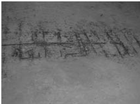
Рис. 1. Разрушение плиты перекрытия в зоне интенсивного увлажнения
