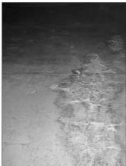
Рис. 2. Высолы на нижней стороне плиты перекрытия в зоне интенсивного увлажнения
